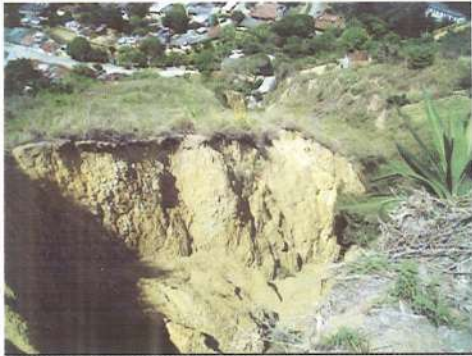
Inicio de los trabajos: se observa el barrio La Gran Colombia en situación de alto riesgo Septiembre 2004
