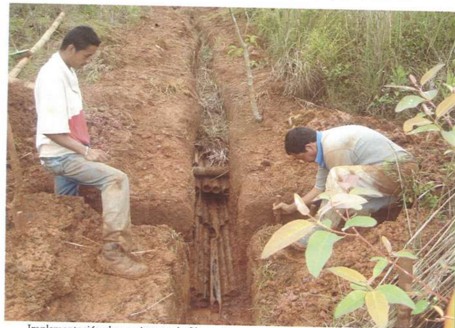
Implementación de un sistema de filtros vivos para la evacuación de aguas subterráneas.
