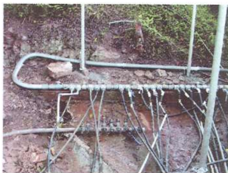
Una fuga persistente de agua puede ser el origen de enormes remociones masales. Cuenca del Río Cali.
