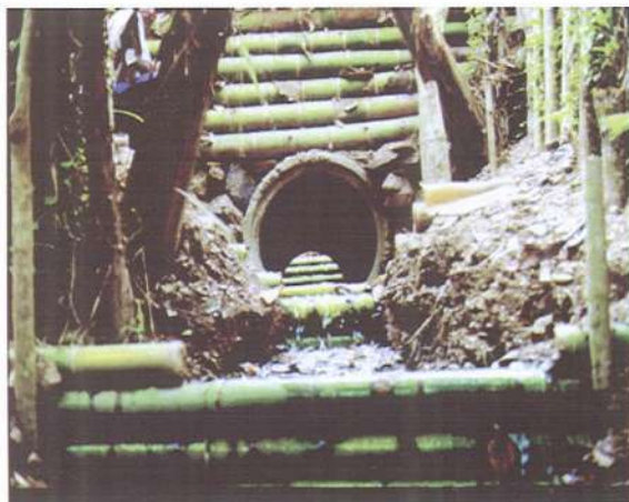
Establecimiento de tubería para conducir las aguas de la quebrada por debajo de la banca de la carretera. Se observan trinchos vivos escalonados a ambos extremos de la tubería.
