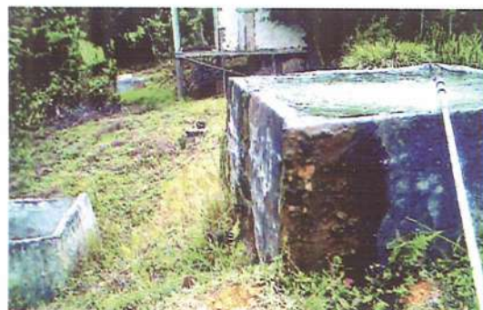
Los tanques de almacenamiento de agua requieren de un mantenimiento periódico y un monitoreo permanente.
