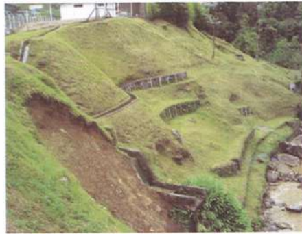
Se estima que la vida útil de obras como muros de concreto y gaviones oscila entre 6 y 8 años en el trópico húmedo.
