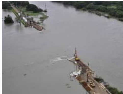
Figura 1.25. Rotura del canal del Dique. Año 2010
