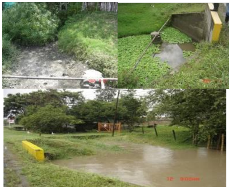
Figura 3.23. Pulsos hidráulicos. Nótese para el mismo punto (BoxCulvert Via), las distintas variaciones de agua, desde nulas, normales y extremas para un mismo año
