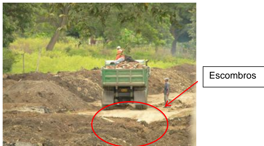
Figura 3.25. Presencia de escombros en el humedal y su cuenca de captación
