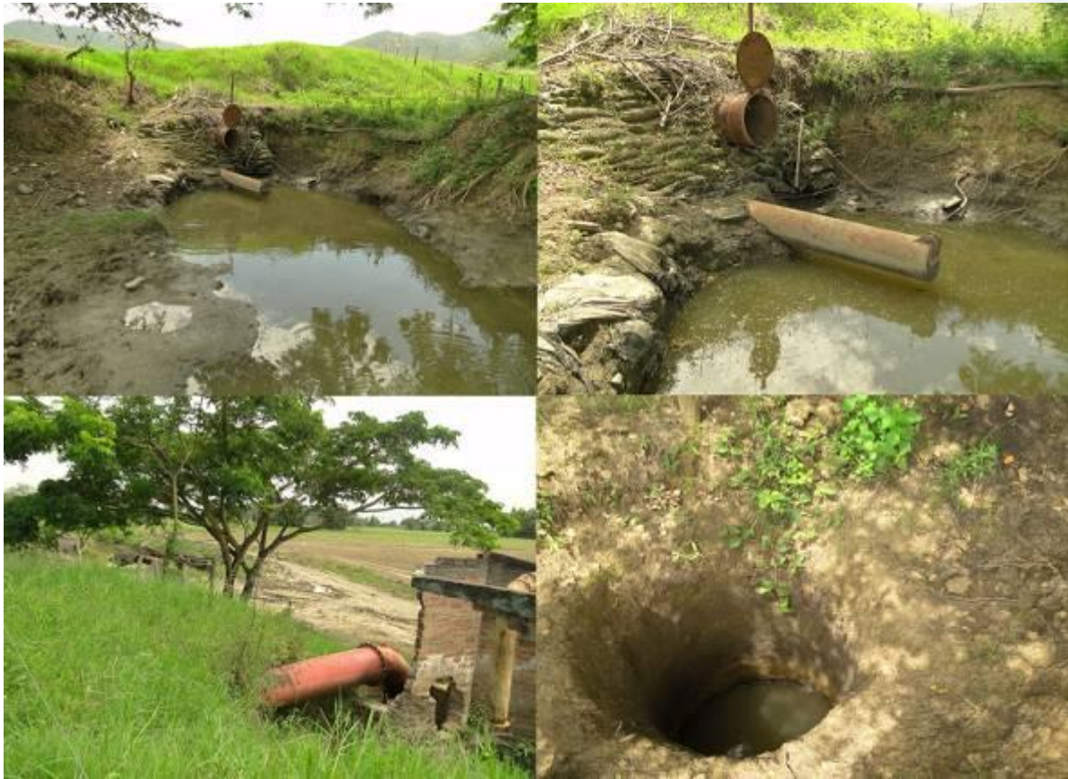
Figura 3.26. Captación para riego
