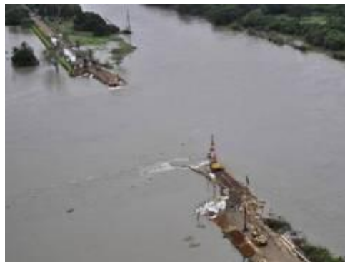
Figura 1.22. Rotura del canal del Dique. Año 2010 Fuente. URL-3
