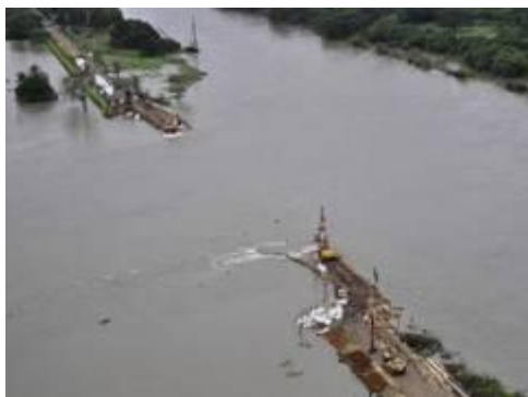
Figura 1.24. Rotura del canal del Dique. Año 2010
