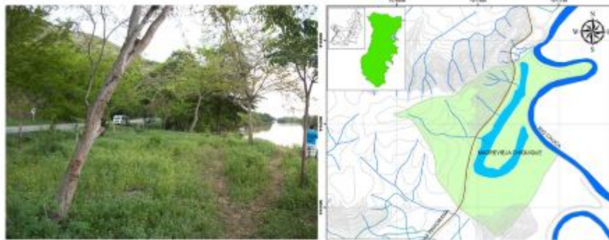
Figura 3.7. La Vía Panorámica a traviesa la Cuenca del Humedal. El Pie de Monte se encuentra erosionado
