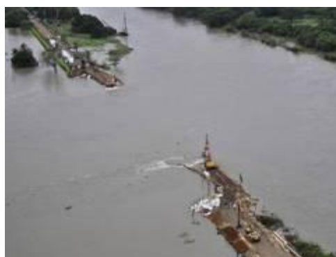
Figura 1.25. Rotura del canal del Dique. Año 2010
