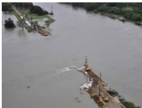
Figura 1.25. Rotura del canal del Dique. Año 2010 Fuente. URL-3
