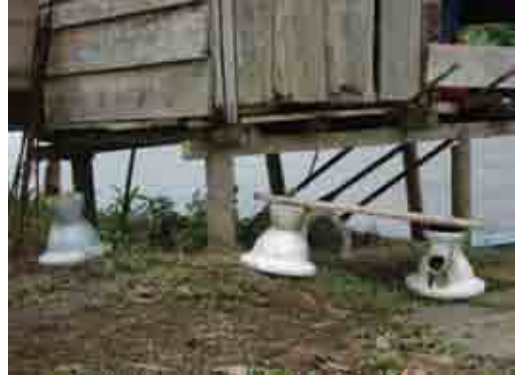
Foto 65: Baterías sanitarias vereda Silva
