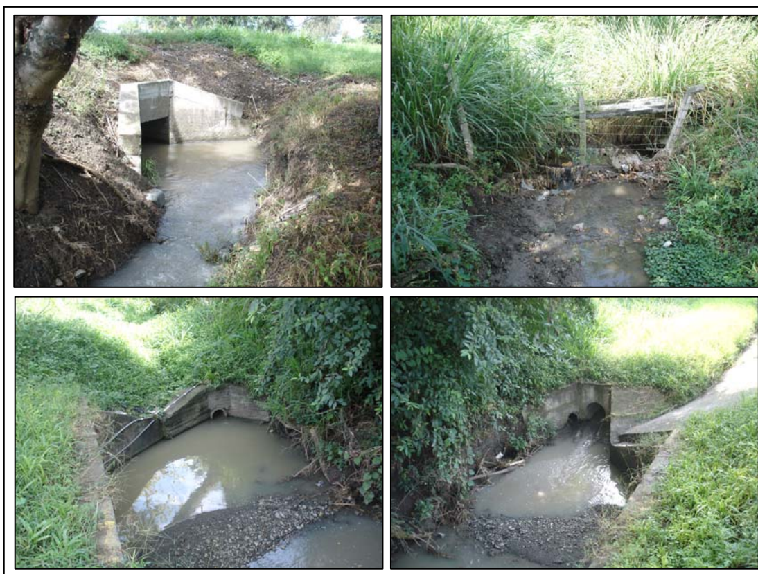
Foto 5. Descarga de Aguas Residuales en la cuenca de Captación de la Laguna de Sonso
