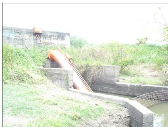
Foto 22. Estación de Bombeo en la Hacienda Bello Horizonte
