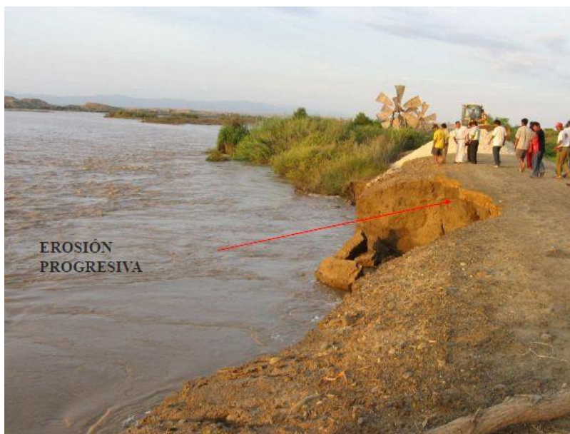
Fotografía 32. Erosión progresiva sobre barranco del cauce de un río
