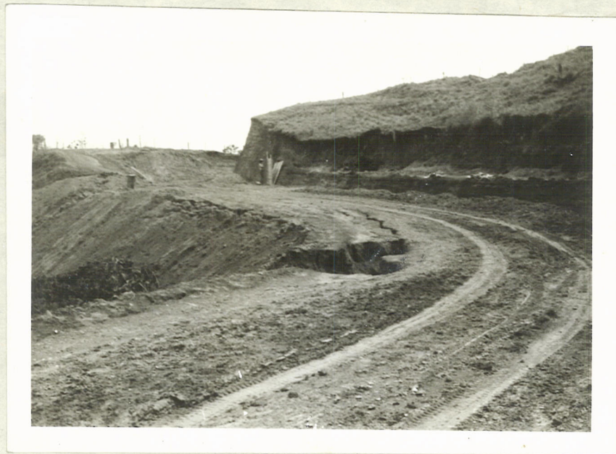
Fotografía No. 10 Zona de inestabilidad en la banca de la carretera Morales-El Hato - K. 6 + 800
