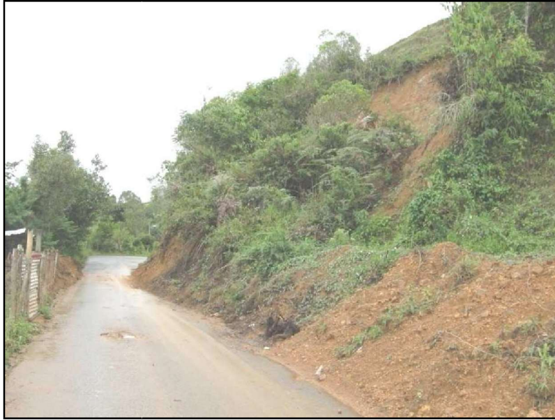
Foto 5.4 Deslizamiento de suelo en el talud de la carretera que conduce a Ansermanuevo.
