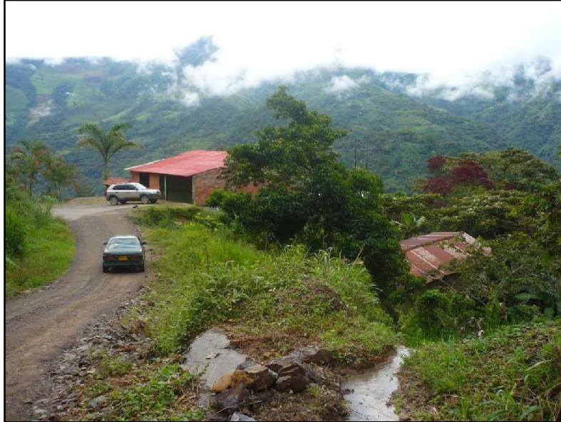
Foto 7.1 Hundimiento de vivienda sector La Nibia.
