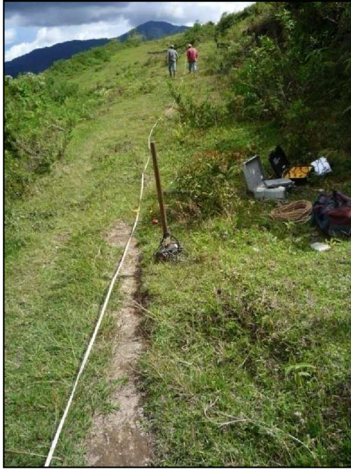
Foto 6.19 Localización Línea de Refracción Sísmica L-17 en el Barrio Alto de La Cruz.
