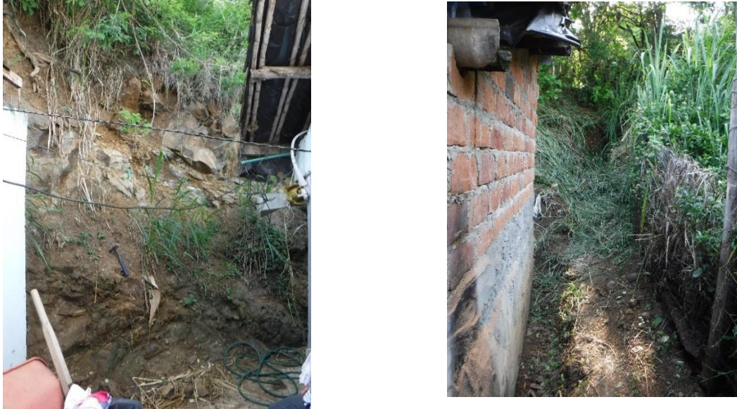
Figura 3.48. (T005): Ejemplo de talud vertical en parte de atrás de casas, el cual linda con patios o habitaciones poniendo en riesgo los habitantes de dichas edificaciones.
