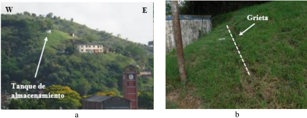
Figura 3.47. (T009): a. Vista general del cerro La Cruz y de las instalaciones de Acuavalle. b. Al lado E del tanque (lado derecho en la foto) se aprecia grieta que sirve de canal para guiar agua lluvia y empozarla al lado del poste, nótese que el poste ya está levemente inclinado
