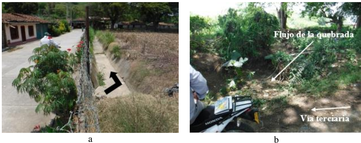
Figura 3.58. a. (T021): Calle 18, donde la canalización hace un giro no natural de 90° provocando desbordamiento de la quebrada. b. (T022): Más debajo de la estación T021 la quebrada llega a la vía terciaria que pasa por la ladrillera, la cual se ve afectada por el desbordamiento de la quebrada.
