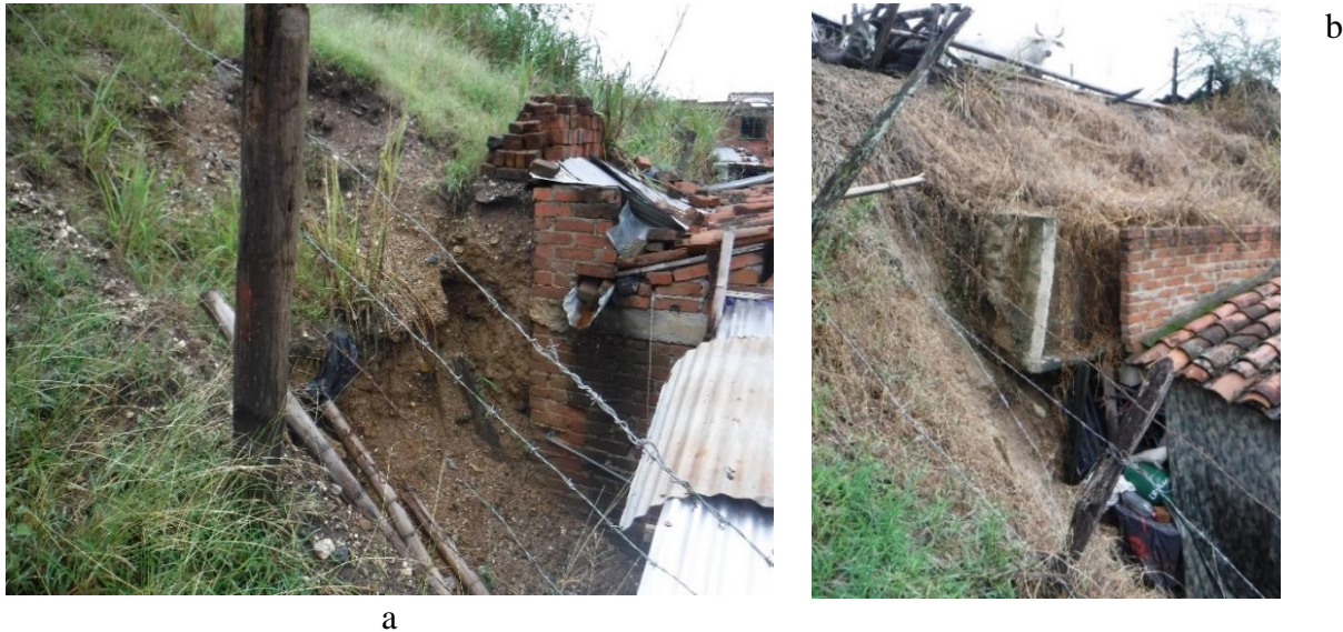
Figura 3.50. a. (T049): casa ubicada en la Carrera 6 #15-109, nótese que el coluvión (Stco) está haciendo presión sobre la pared de dicha casa, la cual es una habitación. b. (T050): Casa en la Carrera 6 # 16-65 presenta la misma situación.
