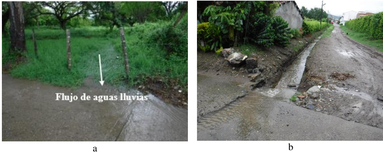
Figura 3.59. (T048): Carrera 6 con calle 14, aguas lluvias que descienden del cerro afectando las casas cercanas, se elaboró el canal en tierra que se observa en la foto de la izquierda para conducir las aguas al box colvert o canal descrito en la estación T011.
