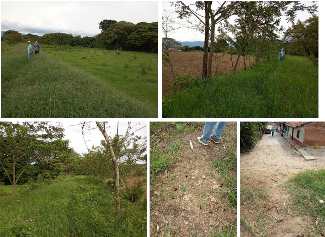
Figura 3.79. Evidencia de condiciones que pueden aportar al deterioro del jarillón (arrieras y árboles creciendo en el jarillón); y corte del jarillón en el barrio Bello amanecer por el tránsito de personas que usan la cara húmeda del mismo para agricultura.
