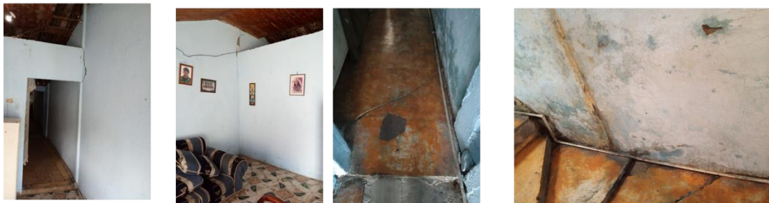
Figura 3.64. Mal estado de la vivienda ubicada en la Calle 1 Sur #1E-17, debido a la afectación por humedad y el movimiento en masa. Barrio Las Brisas.
