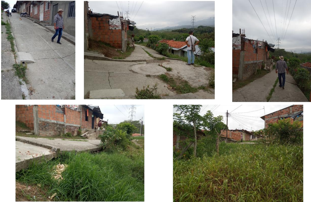
Figura 3.68. Movimiento en masa en la base de la ladera Este del barrio las Brisas. Calle 2 Sur con Cra 3 Este.
