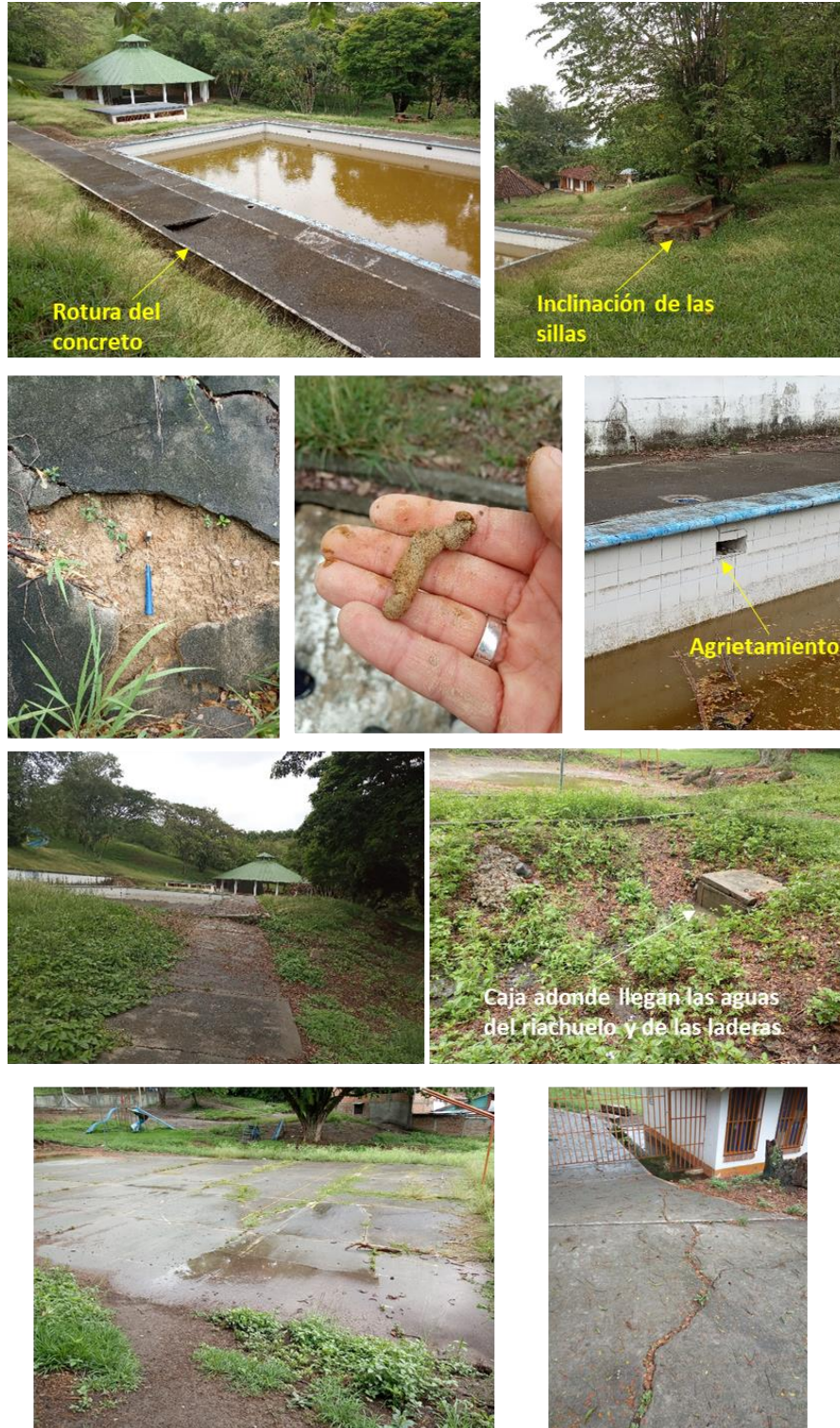
Figura 3.75. Instalaciones del Parque Recreacional en mal estado por inestabilidad del lugar. Fuente: fotografía propia.
