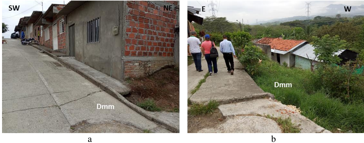
Figura 3.43. a. Fisura en la calle 2 Sur Cra 3Este, barrio las Brisas. b. Deslizamiento rotacional Antiguo, nótese el movimiento a favor de la pendiente.
