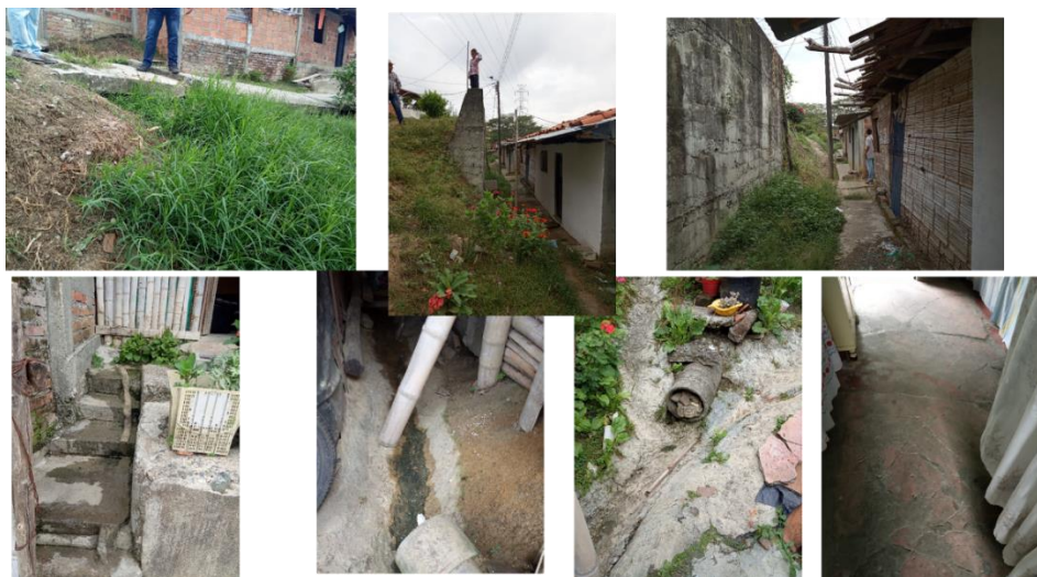
Figura 3.69. Afectación en viviendas sobre la Cra 3Este, ocasionadas por el movimiento en masa, adicionalmente se evidencian tuberías antiguas que filtran agua. Nótese el muro de contención.
