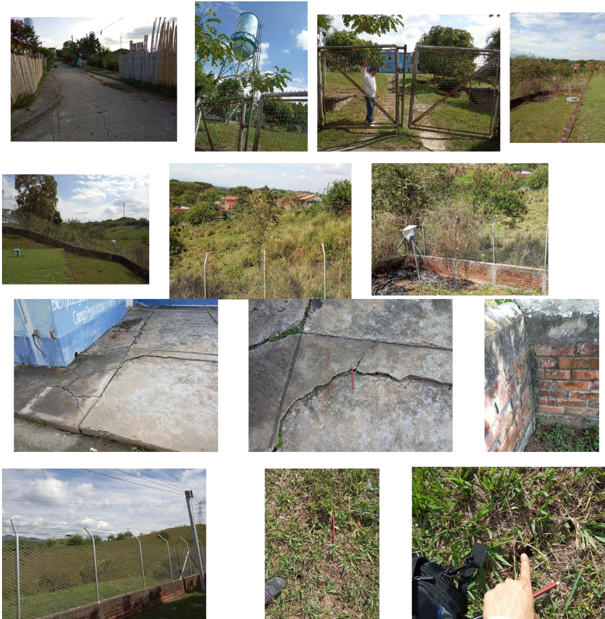
Figura 3.58. Evidencias de reptación en el barrio Las Brisas, sector Acuavalle. Fuente: fotografías propias
