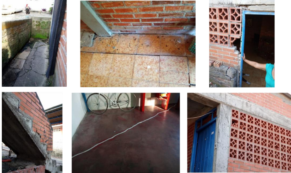
Figura 3.62. Mal estado del Colegio José Hilario López, ocasionado por el movimiento en masa del sector. barrio Las Brisas.
