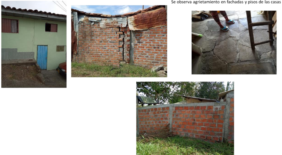
Figura 3.60. Fracturas en fachadas, muros y pisos agrietados en la parte alta del barrio Las Brisas.
