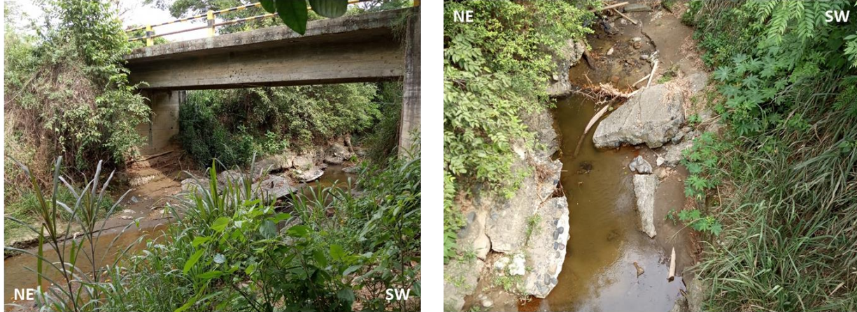
Figura 3.77. Puente sobre la quebrada el Naranjo en la vía que conduce a Villa Rodas. Nótese la presencia de grandes escombros de otros puentes que ha transportado la quebrada.
