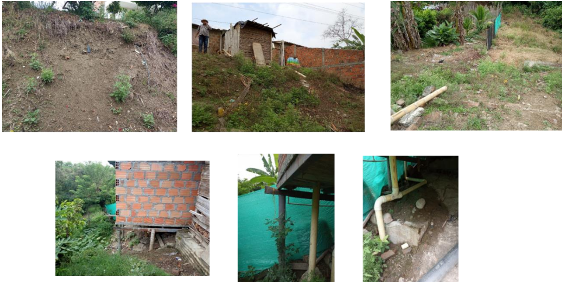
Figura 3.70. Material de relleno y fugas en tuberías de las casas abajo del muro de contención. Fuente: fotografías propias.
