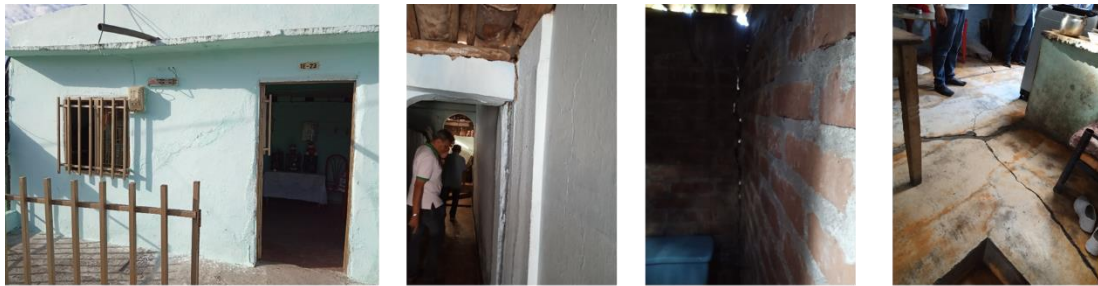
Se observa agrietamiento en fachadas y pisos de las casas
