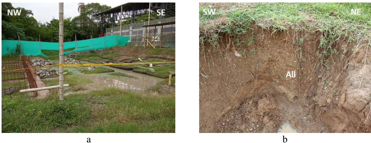
Figura 3.53. a. Barrio en construcción Sagrada Familia, Segunda Etapa. b. Detalle de los Llenos antrópicos mixtos (All) con profundidad observada de hasta 1.5m.
