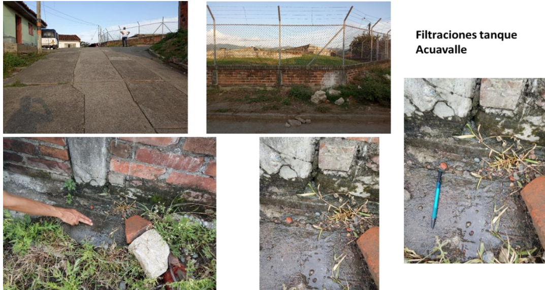
Figura 3.66. Mal estado de las viviendas ubicadas sobre la Calle 1 Sur, debido a la afectación por humedad y el movimiento en masa. Barrio Las Brisas.
