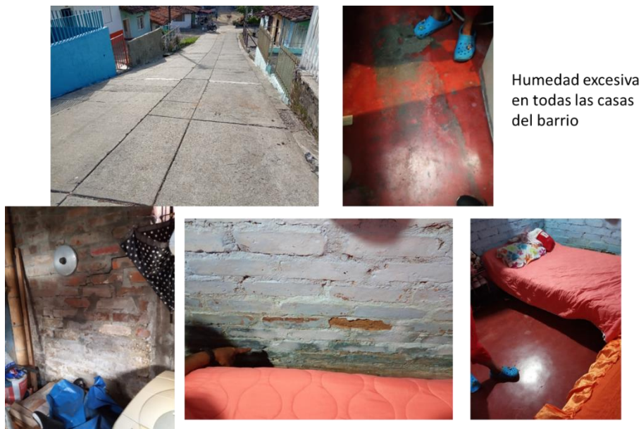
Figura 3.63. Mal estado de la vivienda ubicada en la Calle 1 Sur #1E-17, debido a la afectación por humedad y el movimiento en masa. Barrio Las Brisas.
