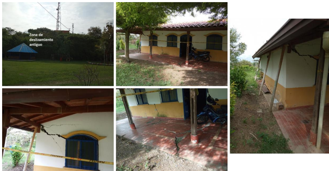
Figura 3.72. Mal estado de las instalaciones del SIM debido al movimiento del terreno. Fuente: fotografías propias.
