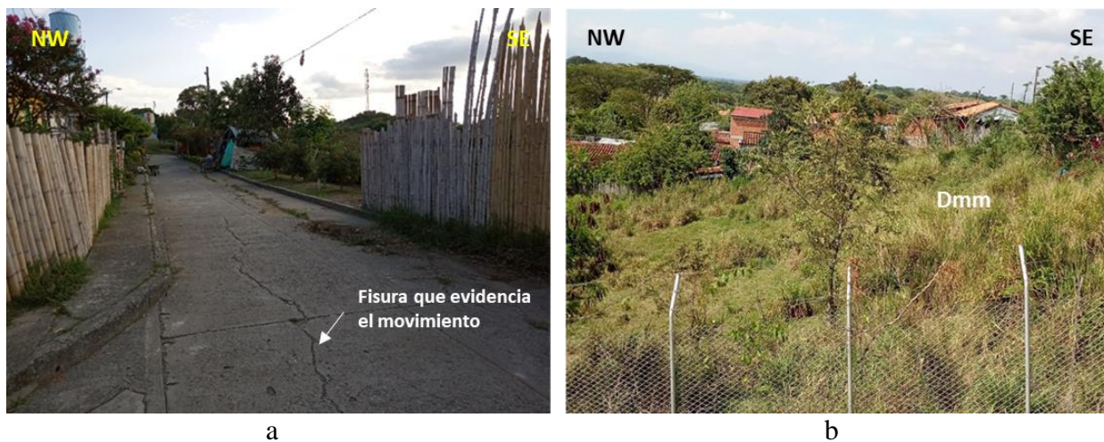
Figura 3.42. Barrio Las Brisas. a. Fisura en pavimento que evidencia el movimiento del terreno. b. Movimiento de reptación evidenciado por el tronco de los arbustos inclinados en dirección contraria a la pendiente, obsérvese además la leve inclinación de la edificación de 2 pisos.
