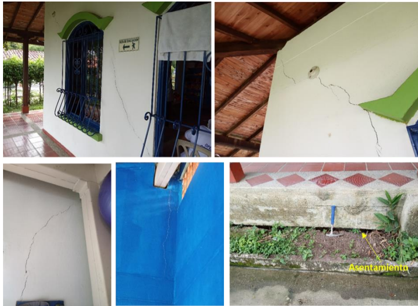
Figura 3.73. Mal estado de las instalaciones en uso actualmente, reforzamiento realizado y evidencia de asentamiento del terreno.
