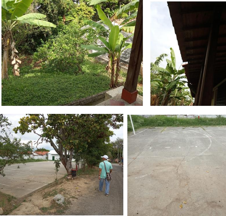
Figura 3.74. Vivienda ubicada en la parte trasera del SIM, tejas a punto de caer y cancha del barrio San Rafael que presenta agrietamiento.
