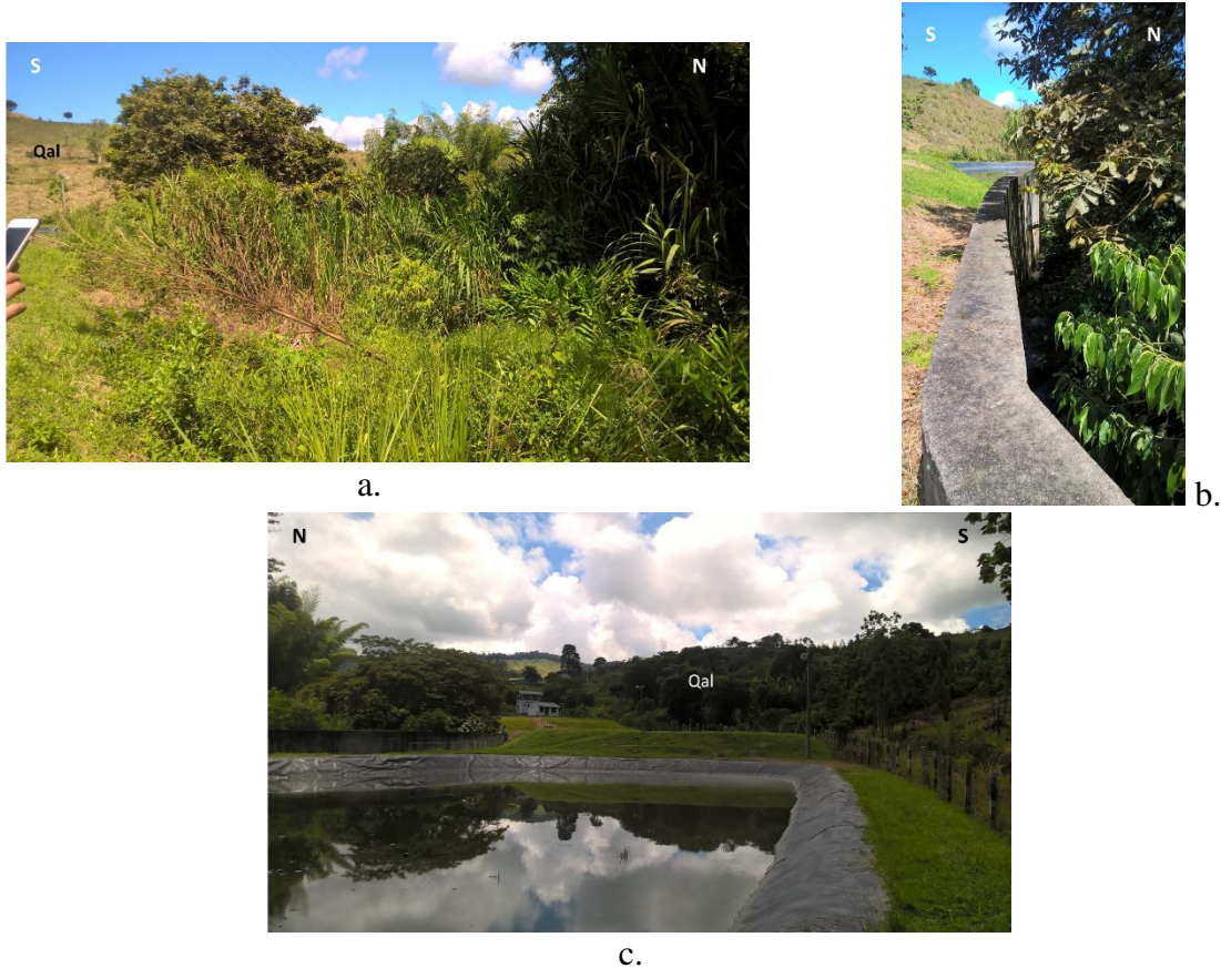
Figura 67. a. Curva erosiva en zona de la PTAR, muy vegetada. b. Detalle del muro que protege la ladera Sur de la quebrada Patuma en la PTAR. c. Obsérvese al Norte la curva protegida por el muro.
