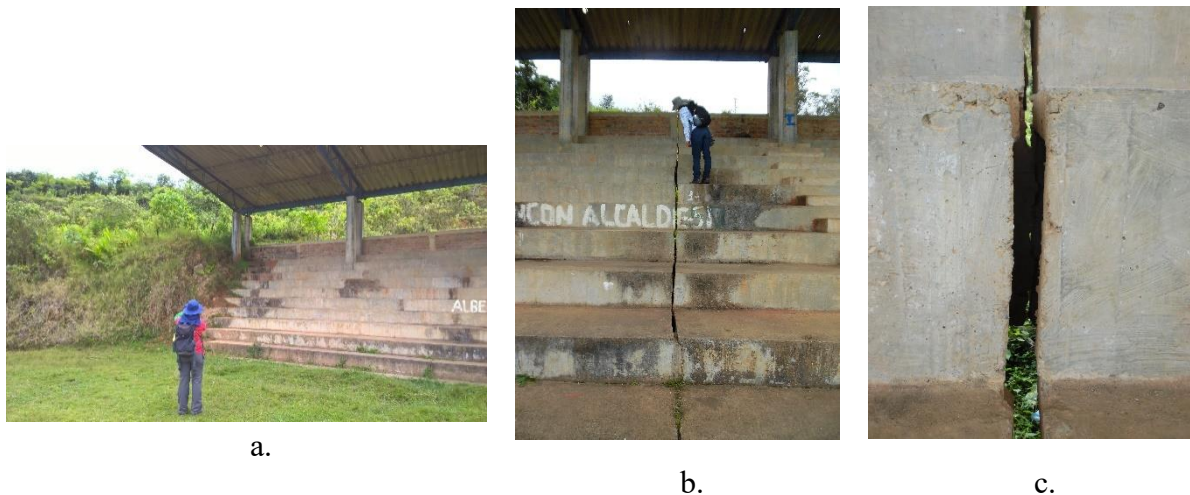
Figura 57. a. Cuerpo de deslizamiento que remonta gradería. b y c. Agrietamiento de gradería.
