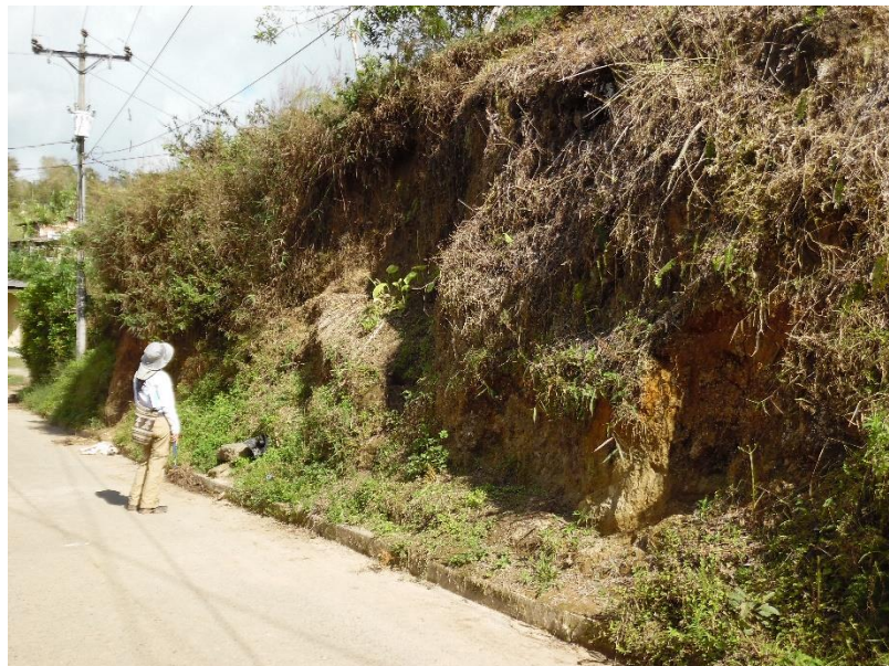
Figura 66. Zona erosiva en la vía que conduce al antiguo matadero.
