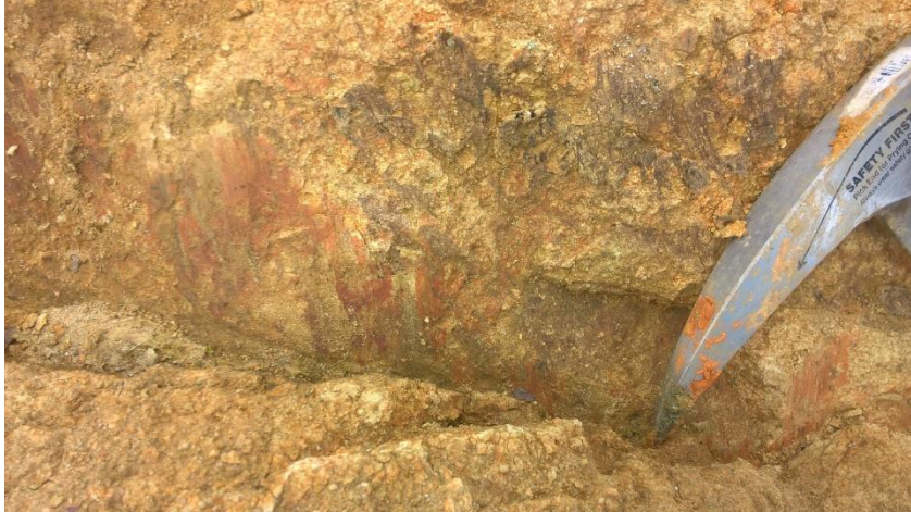
Figura 54. Plano de falla encontrado detrás de gradería cancha municipal.
