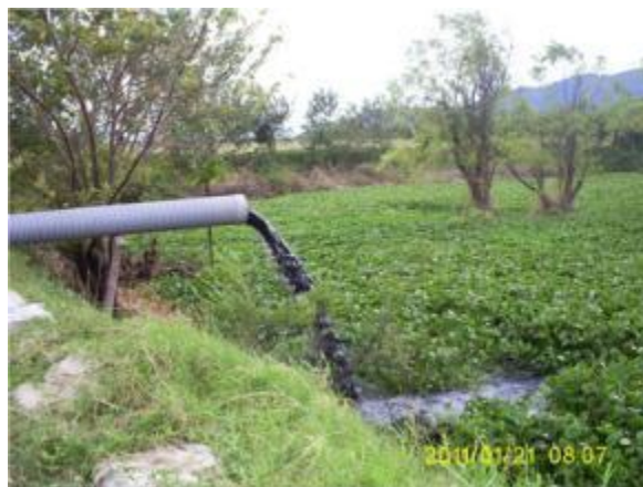
Figura 2.93. Descarga de Aguas Residuales al humedal
