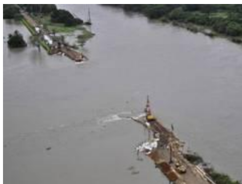
Figura 1.25. Rotura del canal del Dique. Año 2010
