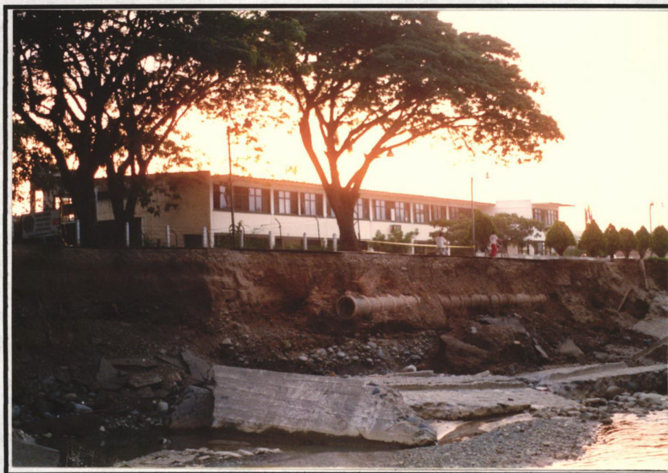
Fotografía 8.20. Nivel de daño en conducciones (ej. Avenida del río Guadalajara, Buga (1997)).
