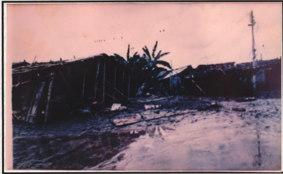
Fotografía 8.18. Estado en que quedaron algunas viviendas del municipio de Florida en la avenida de 1994. Materiales constitutivos y estructuras bastante débiles.
