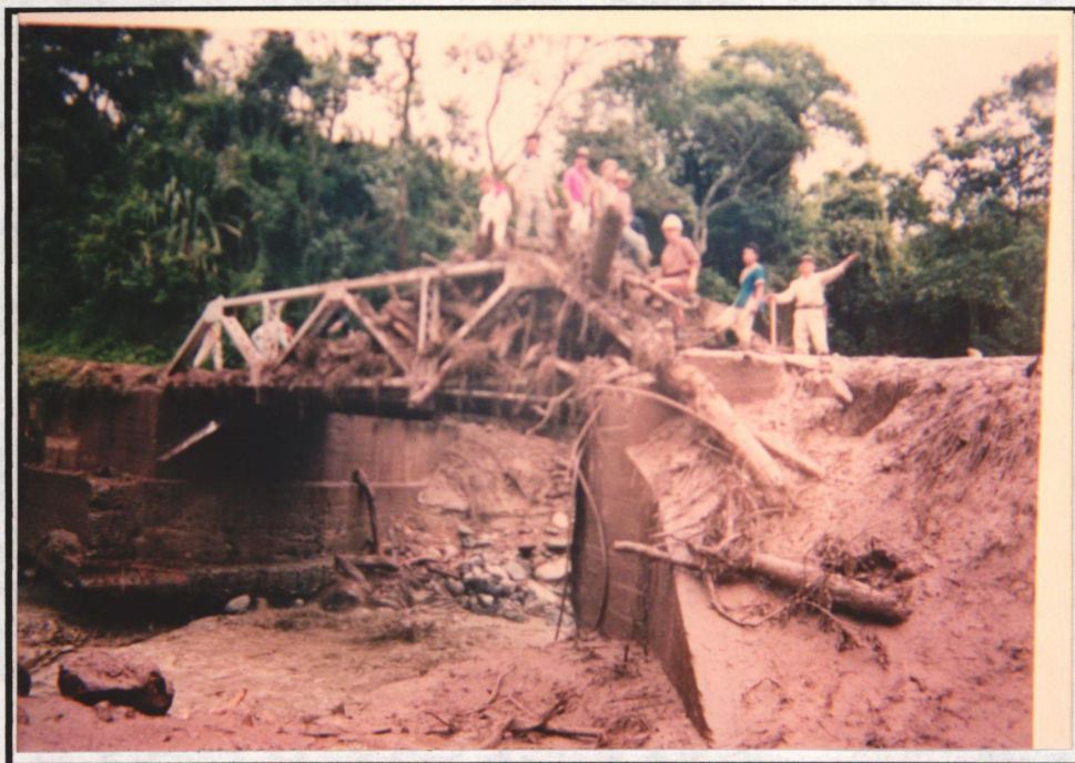
Fotografía 8.19. Acumulación de material sobre las vías de comunicación (ej. Estado del Puente sobre el río Bolo luego de la avenida de 1994. Este puente comunica a Potreritos con el municipio de Pradera).
