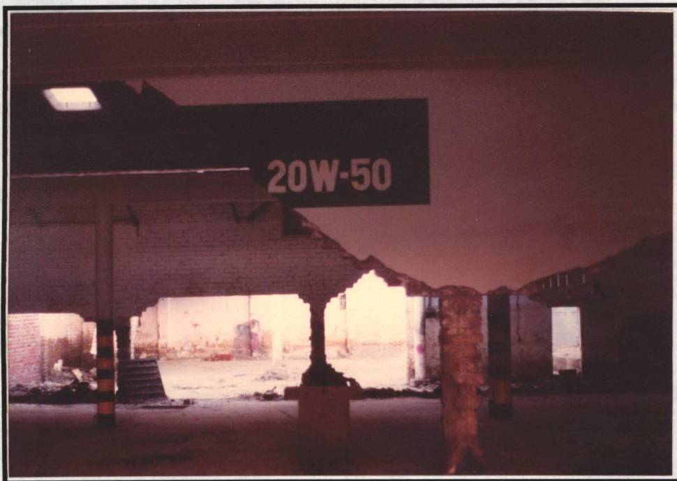
Fotografía 8.15. Daños en muros causados por un flujo de materiales de grano medio a fino, a gran velocidad. (ej. Avenida del río Guadalajara (Buga, 1997)).
