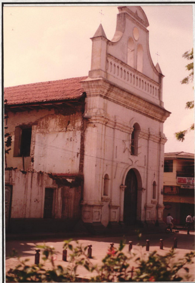
Fotografía 8.9. Antigua Iglesia de Florida. Obsérvese el mal estado de la construcción que puede implicar una menor oposición al fenómeno e incluso favorecer la generación de mayores daños.
