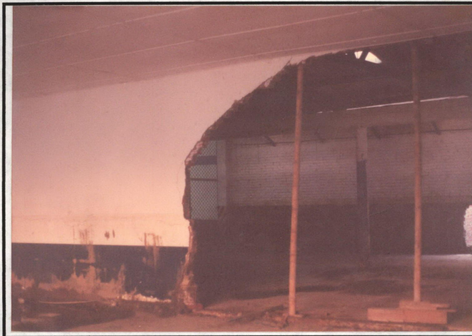
Fotografía 8.7. Los muros de ladrillo no oponen mucha resistencia a la dinámica del fenómeno. (ej. establecimiento ubicado al margen del río Guadalajara (Buga), afectado en la avenida de 1997).
