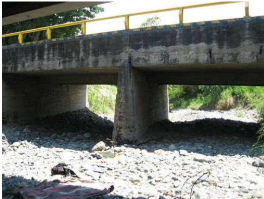
Foto 8.3. Cruce de la quebrada Chambimbal con el puente de la vía Panorámica
