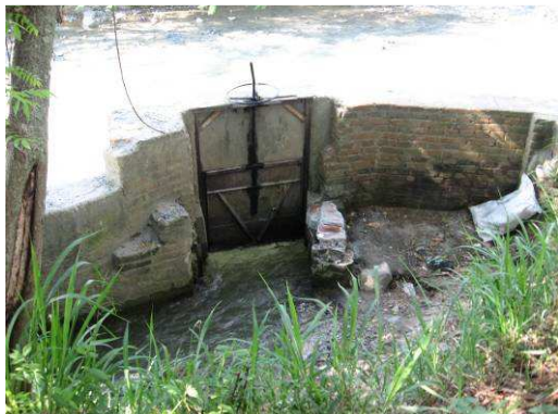
Foto 8.15. Toma de agua de la acequia La Julia
