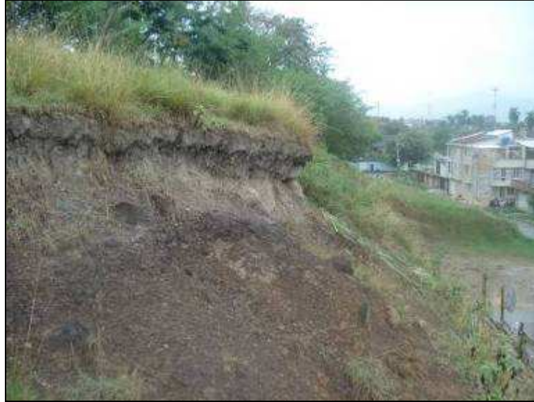
Foto 0.1. Deslizamiento sector Alto Bonito.
