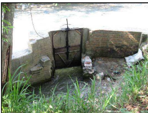
Foto 15. Toma de agua de la acequia La Julia.
