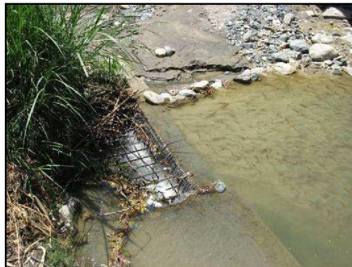
Foto 18. Bocatoma de la acequia El Chircal.
