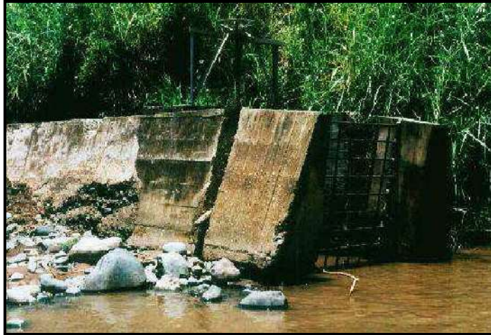
Foto 4. Entrada de agua, acequia El Tablazo (Fuente: Informe de bocatomas del río Riofrío (CVC, 1997))
