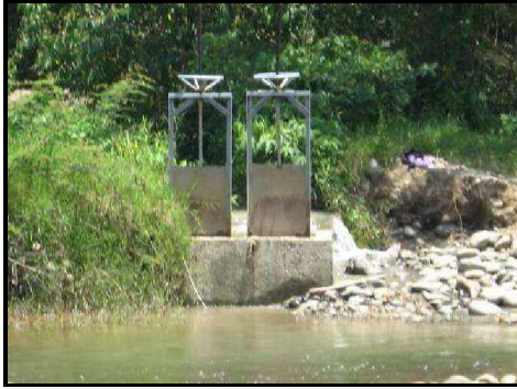
Foto 13. Estructura para la captación de agua en el río Riofrio - acequia La Liga.
